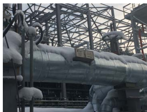
Fig 6 : orifice de restriction multi-étagé installé et calorifugé
